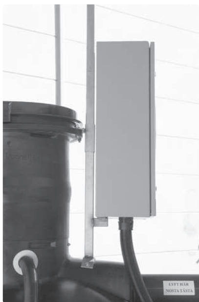
Styrsåkåp i transportlåg.
